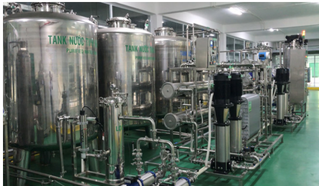
Hình 7. Hệ thống xử lý nước hoàn chỉnh
